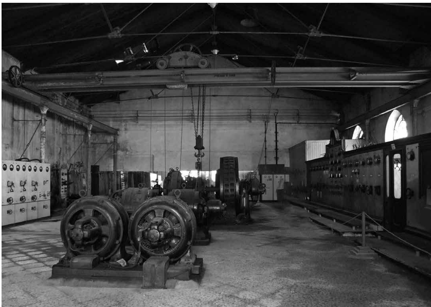
13. Venezia. Arsenale vecchio, la Stazione di forza e luce realizzata nel 1902 all'interno di uno dei cantieri quattrocenteschi dell'Arsenale nuovo (foto Claudio Menichelli, 2005).
