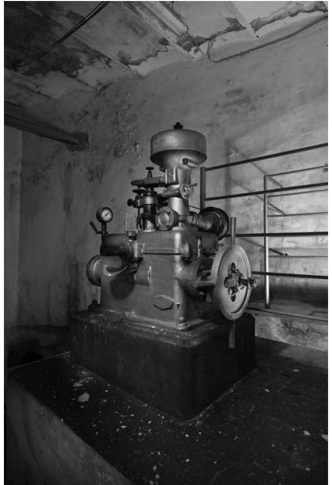
8. Fermignano (Pesaro e Urbino). Controllo meccanico distributore della turbina San Giorgio da 200 hp del 1947 (foto Silvano Bacciardi, 2019).
